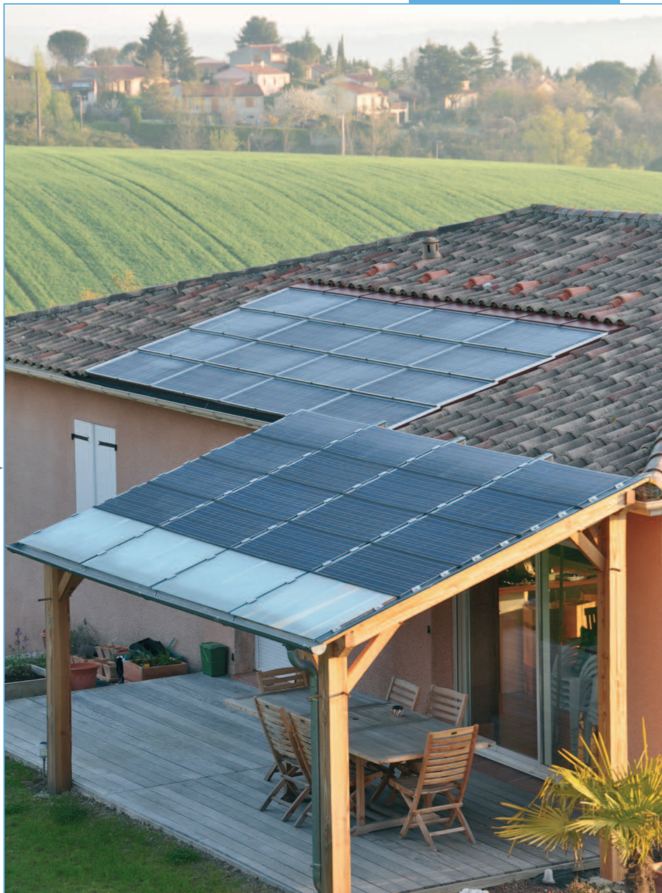
● Une installation photovoltaïque signée Autan Solaire.
